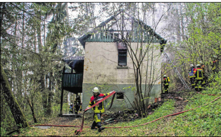
Das zweistöckige Haus in einem Waldstück bei Weil der Stadt brannte aus Foto: SDMG
