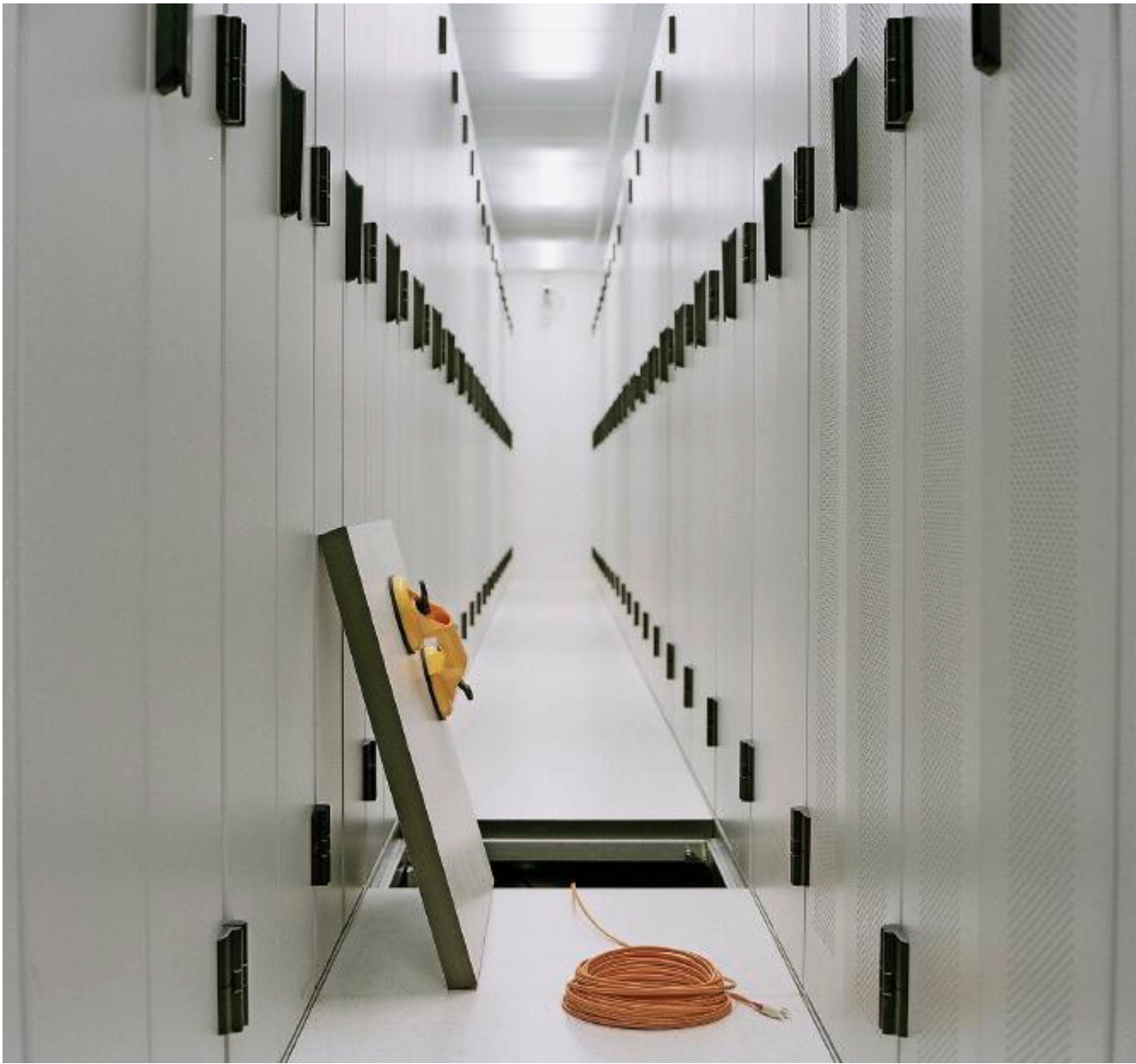
Beim Seco wurden Millionen durch externe IT-Aufträge versenkt: Blick in einen Serverraum. Foto: Granser (Laif)
