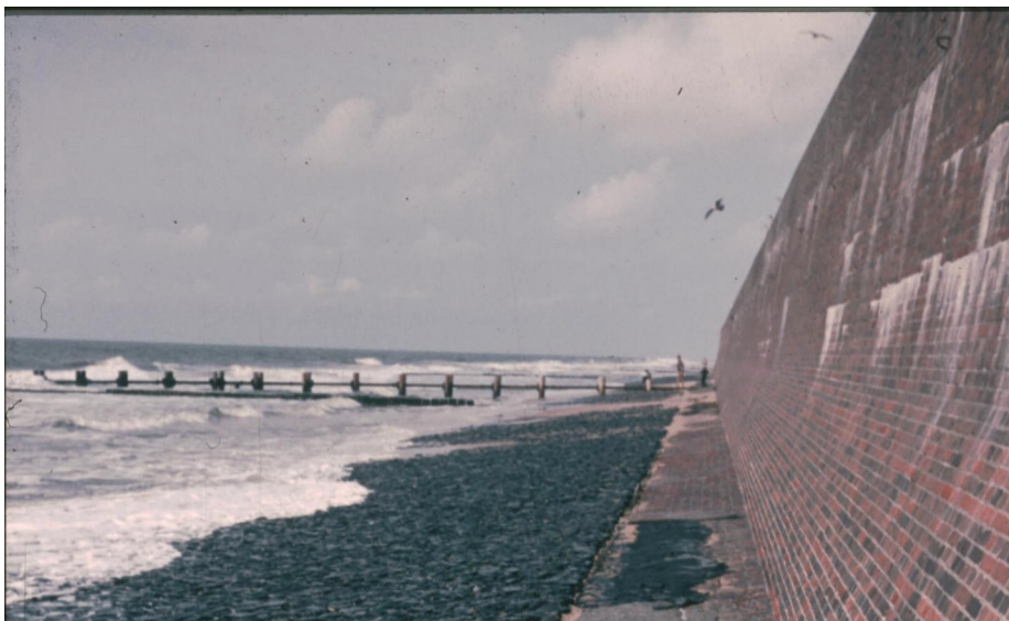
Die Ufermauer in den 1960er Jahren: Vor den ersten Sandaufspülungen gab es keinen Sand mehr vor Westerland.
