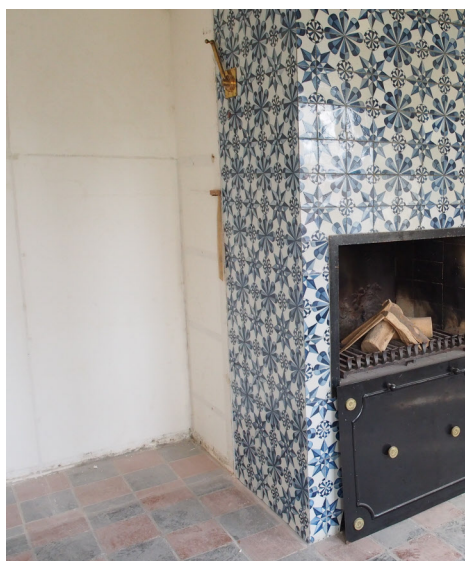
Durch einen Wasserschaden sieht man im Augstein-Haus heute nicht mehr viel vom alten Prunk. Die Fliesen sind aber noch erhalten. PFEIFER
