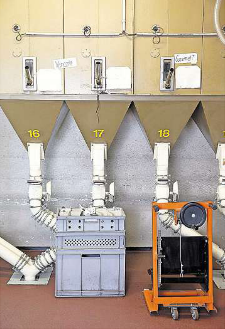
Der fertig geröstete Kaffee wird nach Typ sortiert in Silos gefüllt. Von hier kommt er durch die weissen Rohre in die Sortieranlage.
